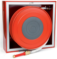
Naspi DN25 DN25 Fire hose Tuyaux d'incendie DN25
